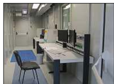
Blick in die Kontroll-Zentrale.
